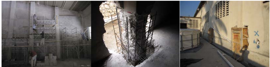
Un entrepôt pour un hôpital: renforcement parasismique des murs et des colonnes
